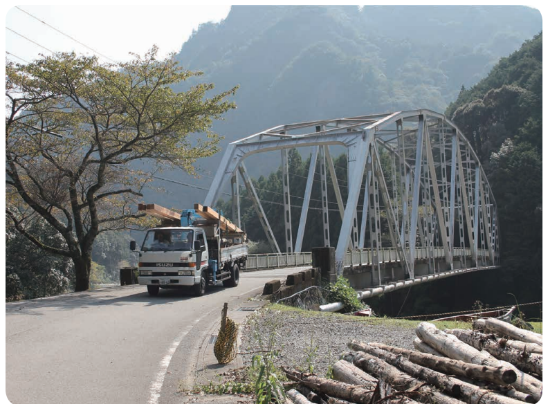
補修予定の洞尾橋
